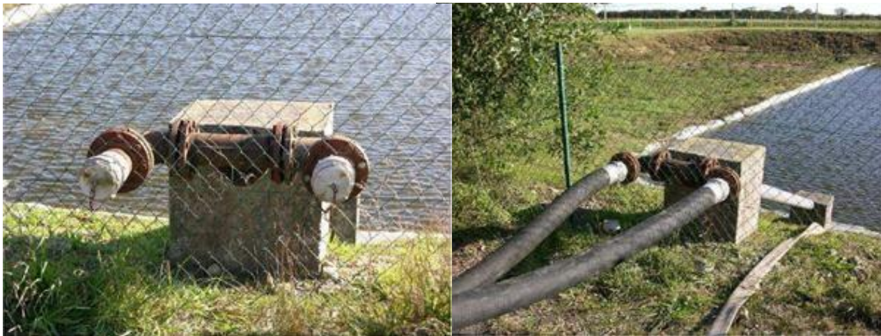
Sortie de Ø 100 mm et canalisation de Ø 150 mm sur une réserve ouverte.
