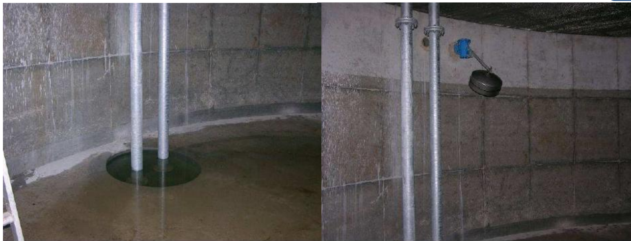
Dispositif d'aspiration totale de \varnothing 100 mm dans une réserve enterrée de 240 \text{ m}^3 , correspond à 2 sorties de \varnothing 100 mm.
